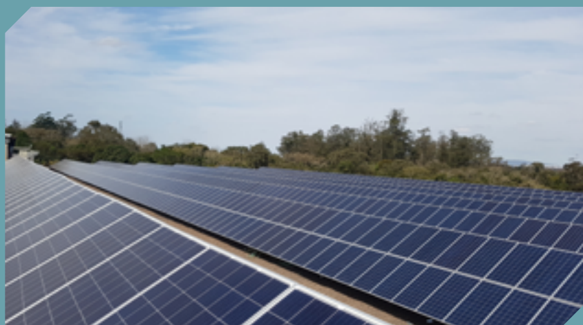
Usina Fotovoltaica de Nova Santa Rita/RS
