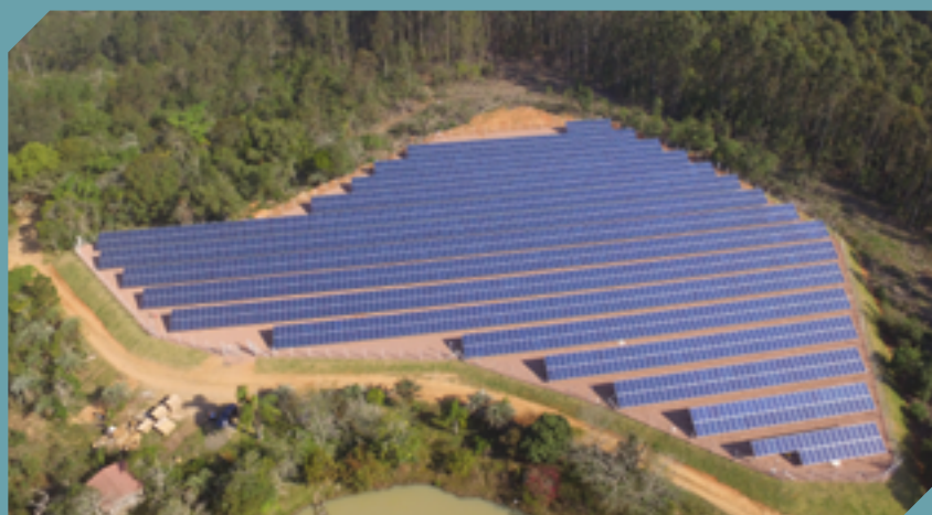
Usina Fotovoltaica de Viamão/RS
